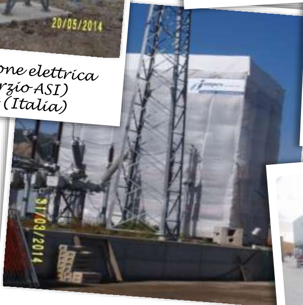
Sottostazione elettrica (Consorzio ASI) Pisticci (Italia)
