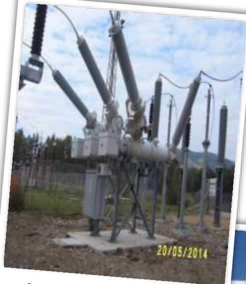
Sottostazione elettrica (Consorzio ASI) Pisticci (Italia)
