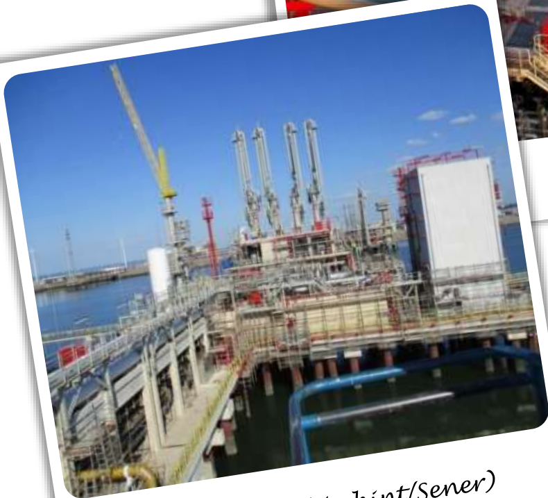
TS LNG BVBA (Techint/Sener) Zeebrugge (Belgio)
