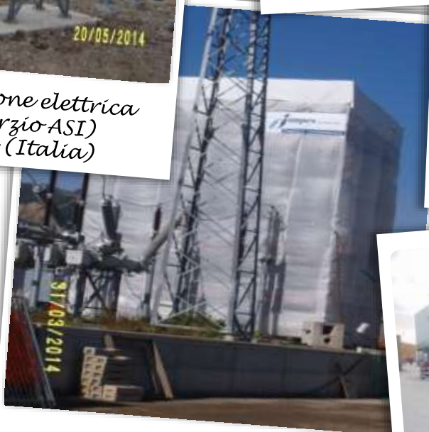
Sottostazione elettrica (Consorzio ASI) Pisticci (Italia)
