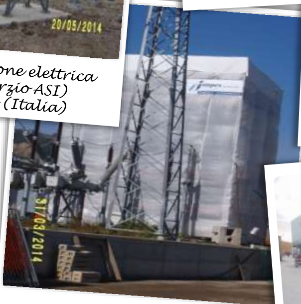
Sottostazione elettrica (Consorzio ASI) Pisticci (Italia)
