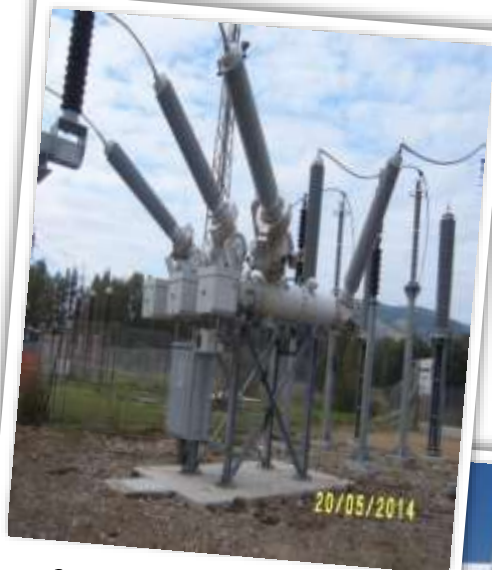
Sottostazione elettrica (Consorzio ASI) Pisticci (Italia)
